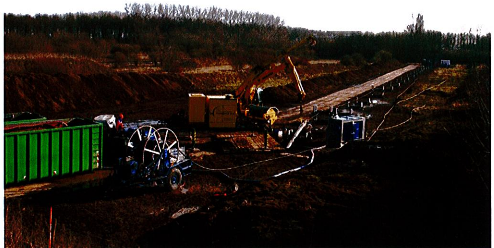
Aanleg van de HDDW in Nieuwegein, maart 2010. De mantelbuis wordt uit het boorgat getrokken
