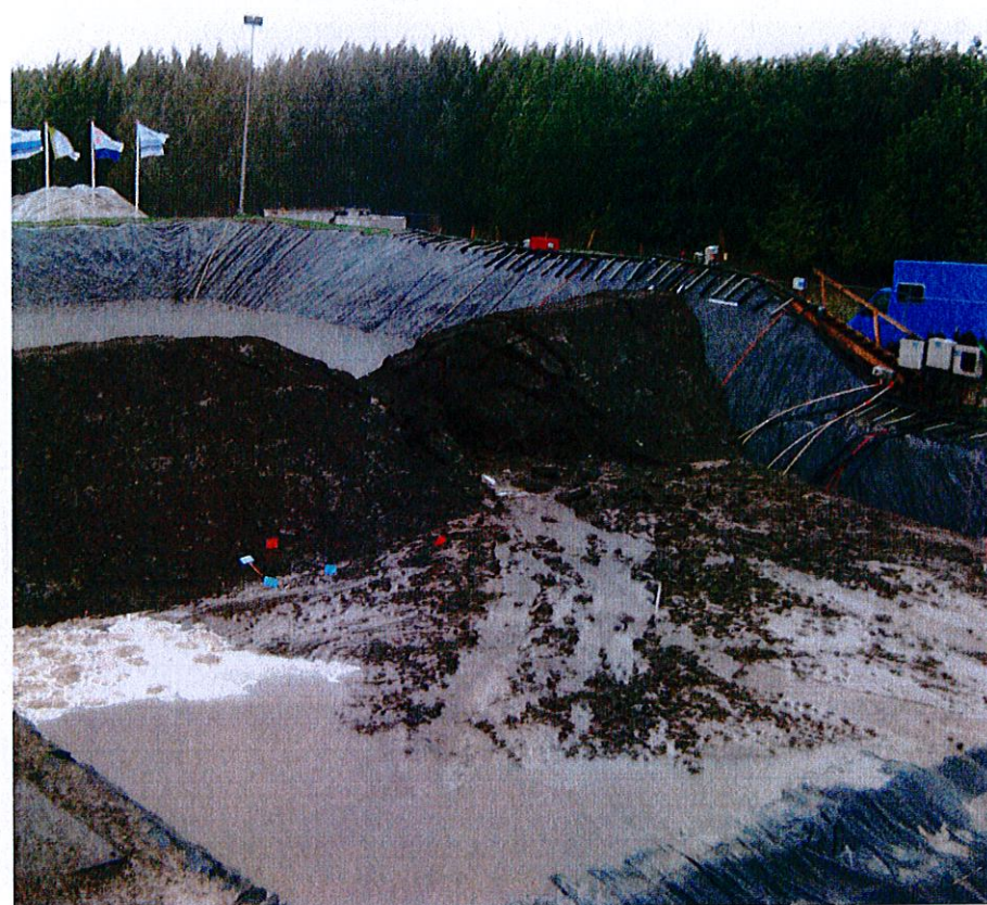
De eerste proefdijk na bezwijken door piping.
